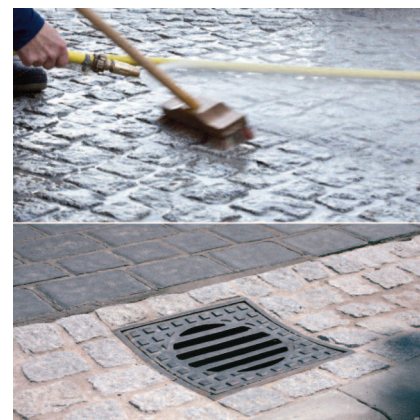
Pri stierkovaní sa PCI Pavifix® CEM jednoducho vtláča do škár gumenou stierkou.
