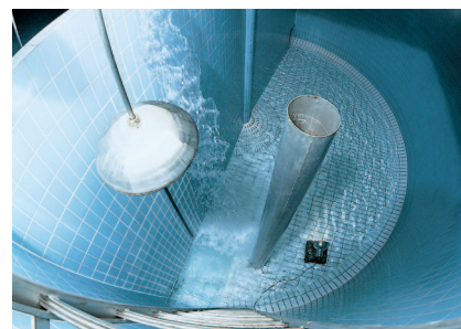
Stykové a dilatačné škáry v zásobníku pitnej vody vyplnené s PCI Silcoferm® KTW. Foto: Buchtal
